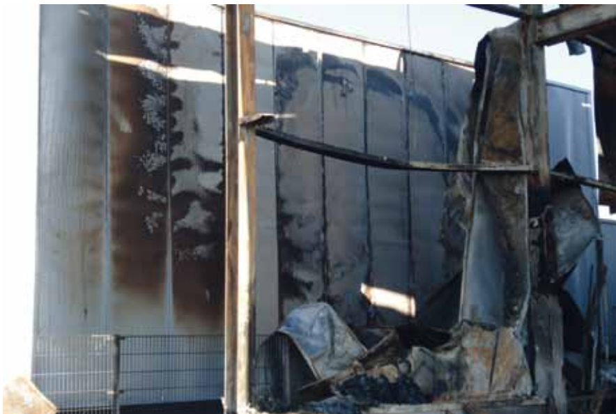
Deze foto is genomen na een brand in Empel (Brabant) waarbij de foto is genomen vanuit het afgebrande pand. Hierin heeft lang een felle uitslaande brand gewoed. De foto is richting de burens genomen waar vroeger een raam zat waar tijdens de brand lange tijd de vlammen uitsloegen en de brandweer moeite had om bij te komen. Het pand van de burens is opgetrokken uit Kingspan panelen en de beide muren stonden slechts 3250mm uit elkaar.
